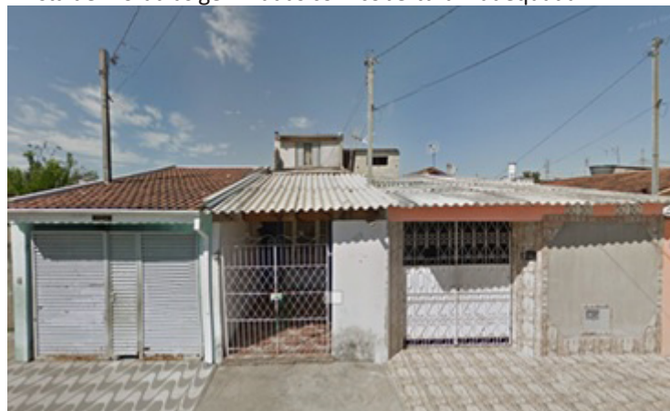
Figura 7. Vista de moradias geminadas com cobertura inadequada
